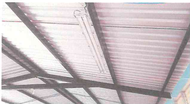
Cambio de lámparas por lámparas tipo led contra polvo y humedad
